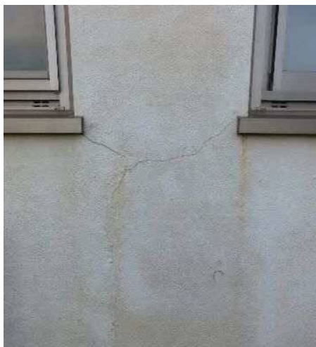
外壁のひび割れ
