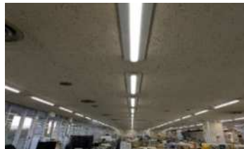
公共施設の照明LED化
