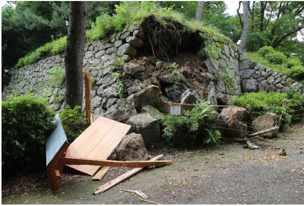
千貫櫓台石垣の崩落（令和3年度）
