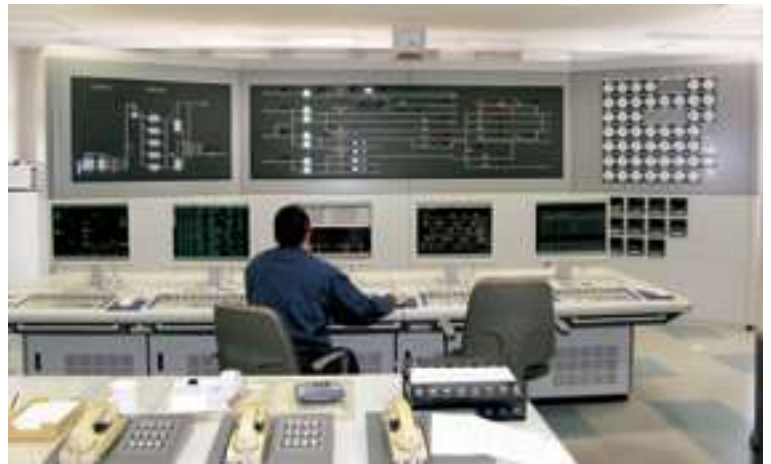
配水圧力の管理室の様子
