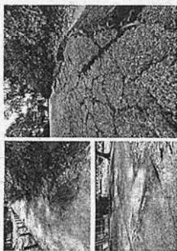
園内路 舗装の割れや隆起した箇所が点在 車いす・ベビーカーでの移動が困難な上、 ジョギングやウォーキングでつまづく危険性も
