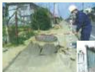
マンホールの浮き上がり (平成23年(2011年)東北地方太平洋沖地震)
