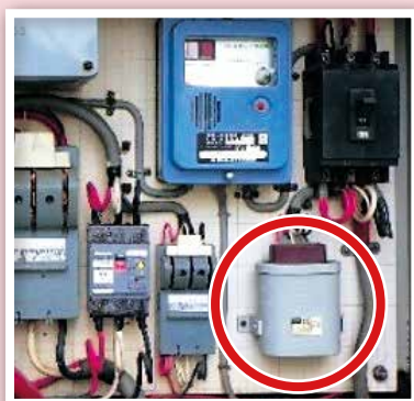
低圧分電盤内の低圧コンデンサー
