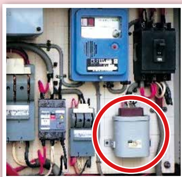
低圧分電盤内の低圧コンデンサー
