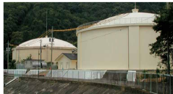
(高山配水池。手前が平成14年度に増設された配水池)
