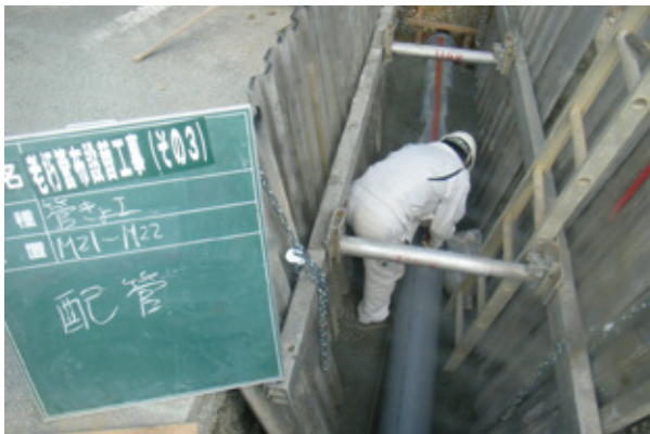
古くなった污水管を取り替えているところ 【老朽管布設替工事】
