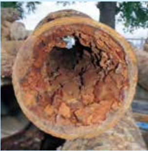
【錆による水道管の腐食】
