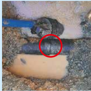
【地中で折れた水道管】
