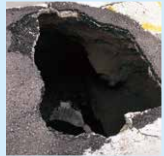
【下水道管に起因した道路陥没】
