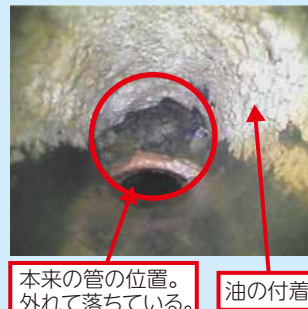
【劣化した下水道管】
