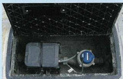
無線機 水道スマートメーター
