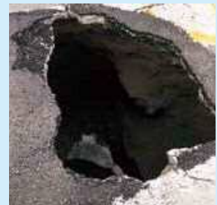
【下水道管に起因した道路陥没】
