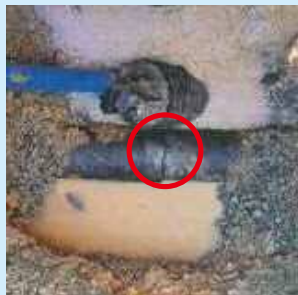
【地中で折れた水道管】
