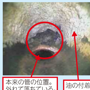
【劣化した下水道管】
