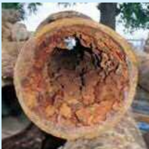
【錆による水道管の腐食】
