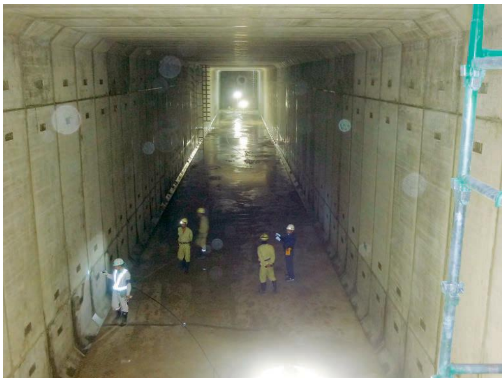
前田南雨水調整池 豊橋市前田南町地内 雨水貯留容量3,600 \text{m}^3 (平成26年度供用開始)
