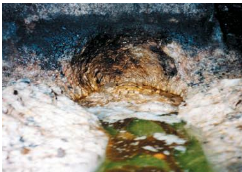
油でべとべとになった管 (下水道管：直径20cm)
