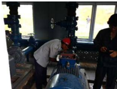
送水ポンプ設備 (軸動力と電動機 出力ミスマッチ)
