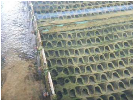
沈殿池の状況確認 (沈殿池出口濁度0度)
