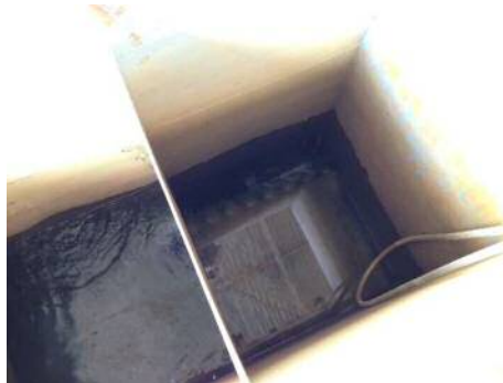
ろ過池の状況確認 (ろ過池出口濁度0度)
