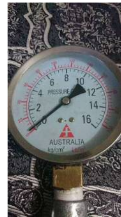
末端配水圧力測定 (配水管網に重大な課題あり)
