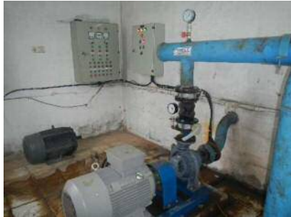
配水圧力の管理 (圧力計取付)
