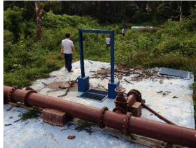
取水ポンプ井 (水が無い)
