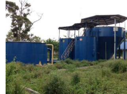
浄水設備 (能力:30l/s)
