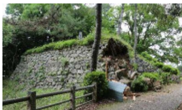
令和3年5月の石垣崩落
