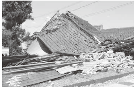
熊本地震で倒壊した建物
