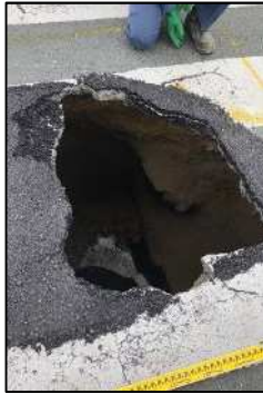
【下水道管きょに起因した道路陥没】
