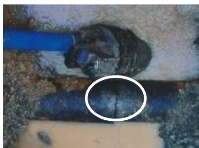
【地中で折れた水道管】
