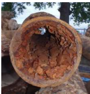
【錆による水道管の腐食】
