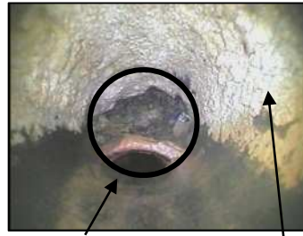
【劣化した下水道管きょ】
