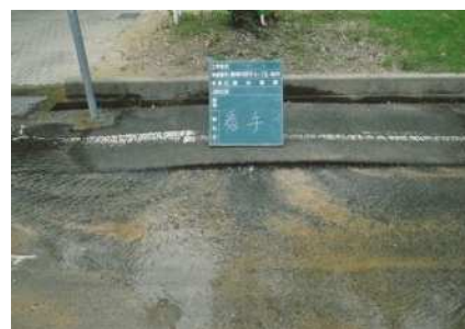
【水道管の破損による漏水】
