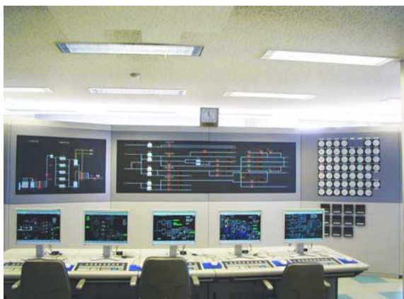
小鷹野浄水場の中央管理室
