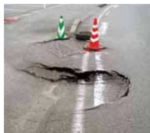
ひび割れ・凹んだ道
