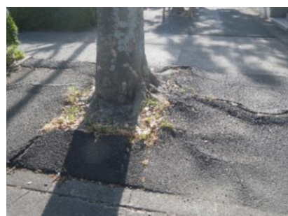
写真 2-5 樹木の根による舗装の持ち上がり
