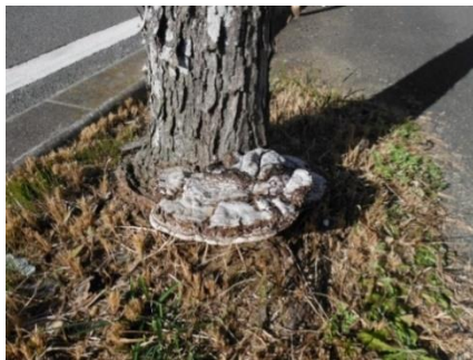
写真 2-2 腐朽菌の侵入によるキノコの発生
