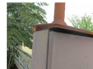
引込開閉器盤
