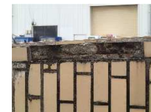
坑門タイルの剥落
