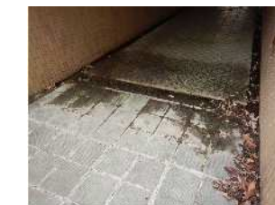
堆積物による排水不良
