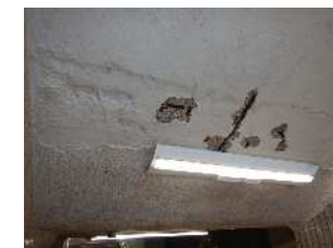
天井コンクリートの剥落
