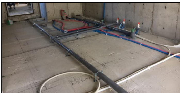
室内の配管の様子です。
