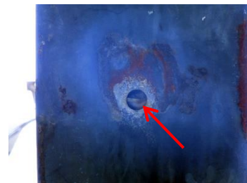
水抜き孔の詰まり
