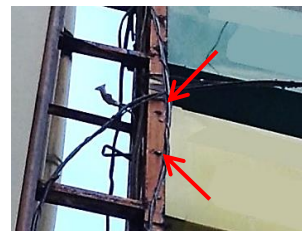
ボルトのゆるみや欠落した状態
