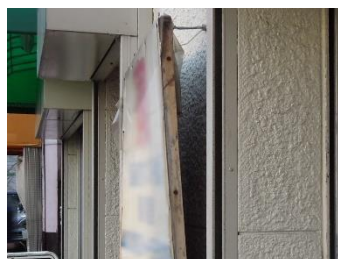
壁面との間に隙間が生じた状態
