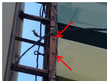
ボルトのゆるみや欠落した状態
