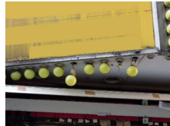
照明器具の傾き、外れ
