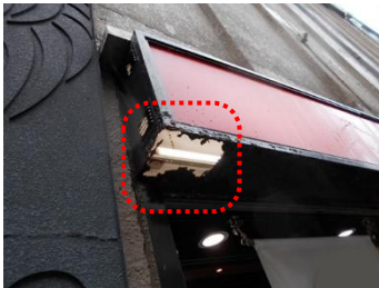
広告板底部の腐食、水抜き穴の詰まり
