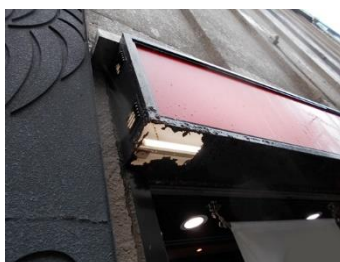
側板底面の腐食が進行した状態
