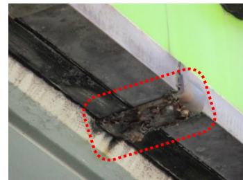
金具が劣化した状態
