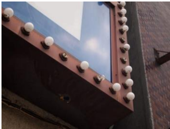
照明の不点灯
