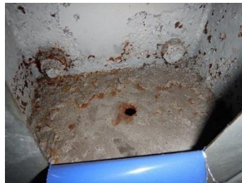
ブラケットの腐食が進行し、劣化した状態
