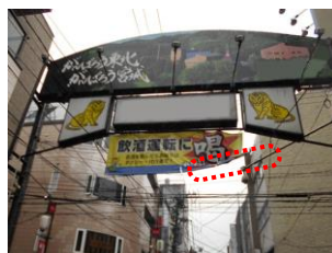
幕材を張る部材が破損した 状態
