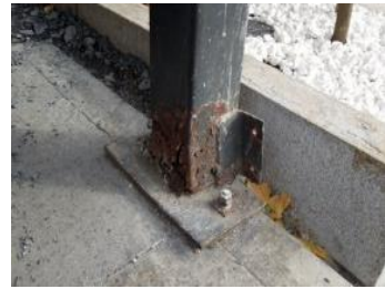
支柱根元の腐食が進行した状態
