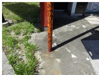
支柱の腐食が進行した状態
