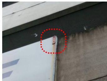
金具が劣化した状態
