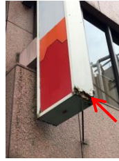
広告板底部の腐食が進行した状態
