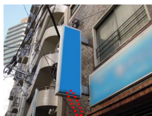
振れ止め棒が変形した状態
