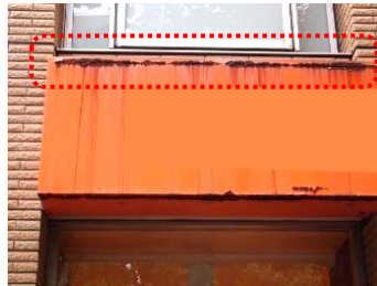
その他（塗装剥離、腐食など）
