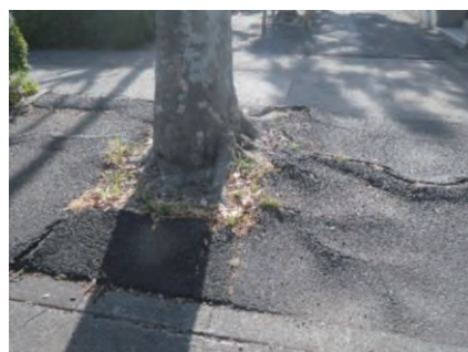
写真 2-5 樹木の根による舗装の持ち上がり
