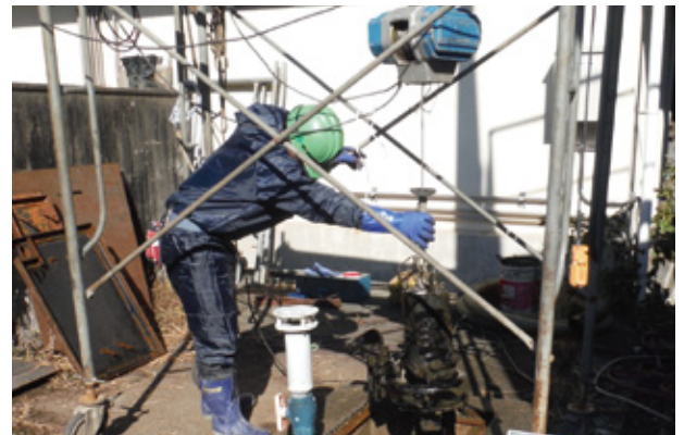
古くなったポンプを取り外しているところ 【機械設備改良工事】
