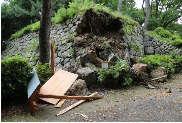
千貫櫓台石垣の崩落（令和3年度）
