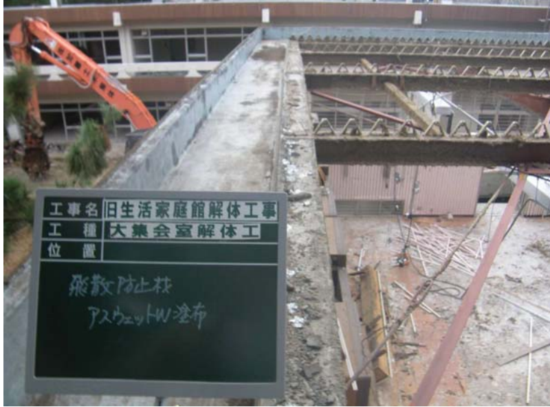
応急措置（固化剤塗布）白っぽく見える部分にアスベストが残存していた
