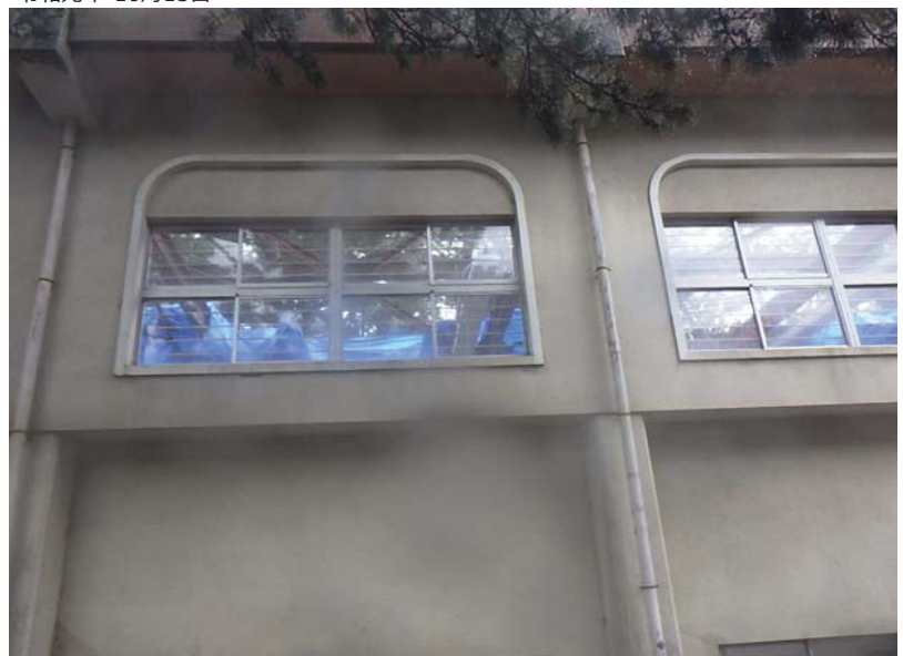
台風19号の風雨により仮設天井が破損
