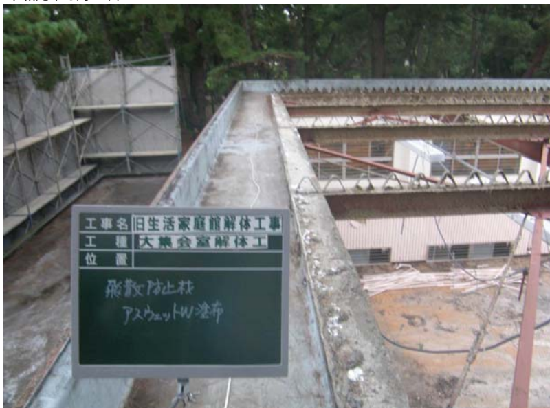
応急措置（固化剤塗布）白っぽく見える部分にアスベストが残存していた
