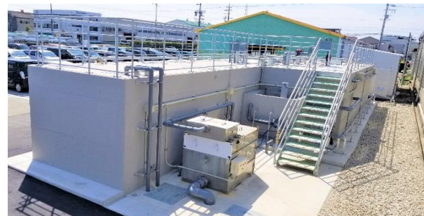
排水処理施設
