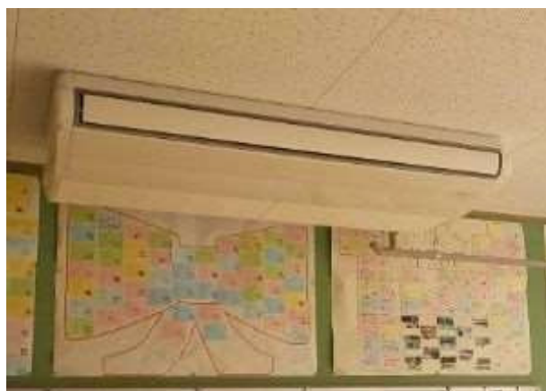
【設置した室内機】
