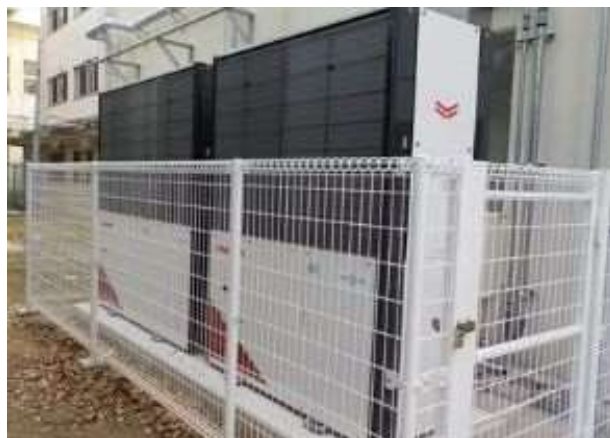
【設置した室外機】
