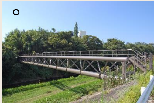
周辺景観と調和する色彩になった水管橋
