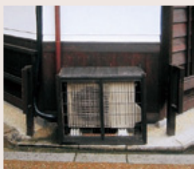
● 空調室外機の覆い
