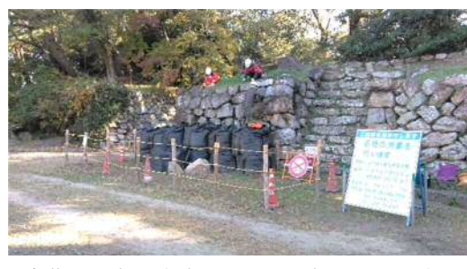
崩落した吉田城址の石垣を調査している様子
