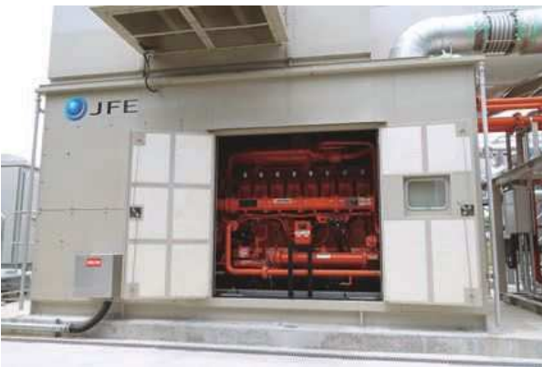
ガス発電エンジン
