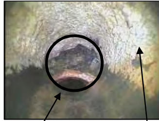
【劣化した下水道管きょ】
