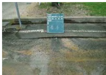
【水道管の破損による漏水】
