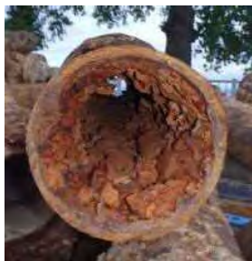
【錆による水道管の腐食】
