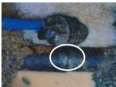
【地中で折れた水道管】
