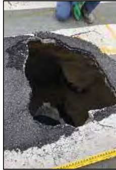
【下水道管きょに起因した道路陥没】
