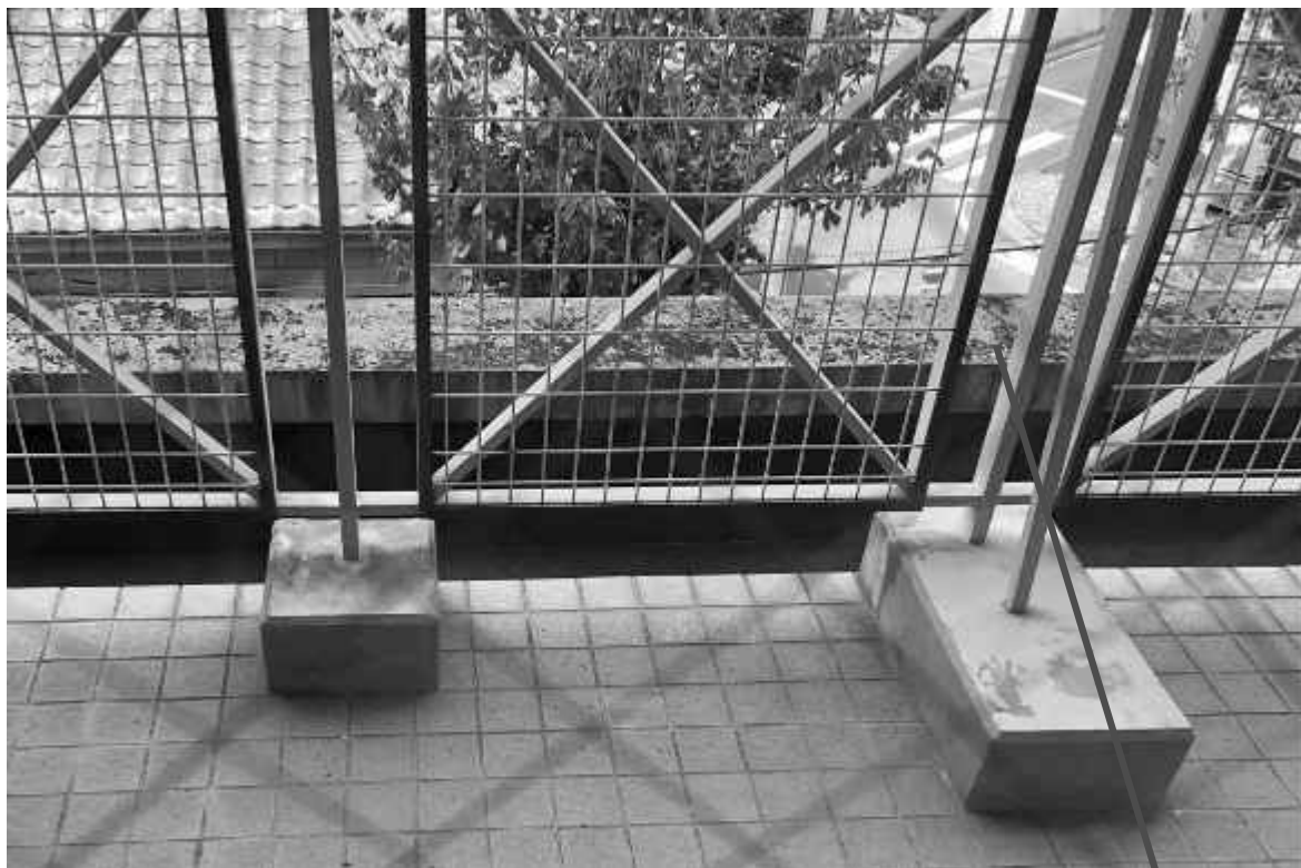
【図表 4 - II 10 - 12】 ベランダの塗装剥がれ
